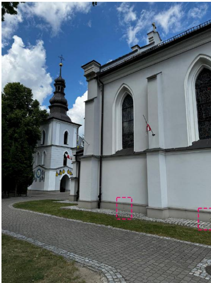
Fot. 10 – Lokalizacja uszkodzonych płyt cokolu na budynku kościoła (elewacja południowa). Źródło: własne
