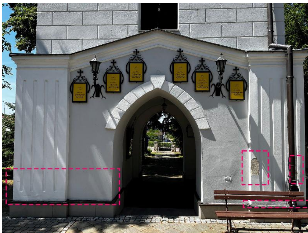
Fot. 20 – Zniszczenia na elewacji wschodniej dzwonnicy. Źródło: własne
