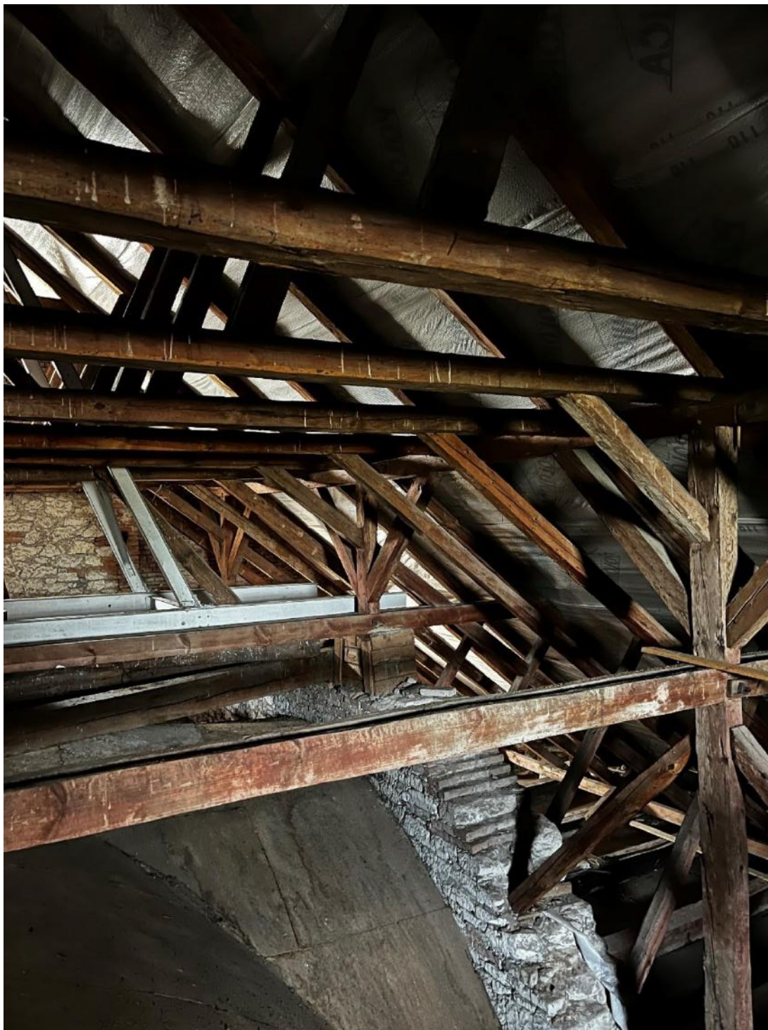
Fot. 42 – Stan więźby dachowej. Źródło: własne.
