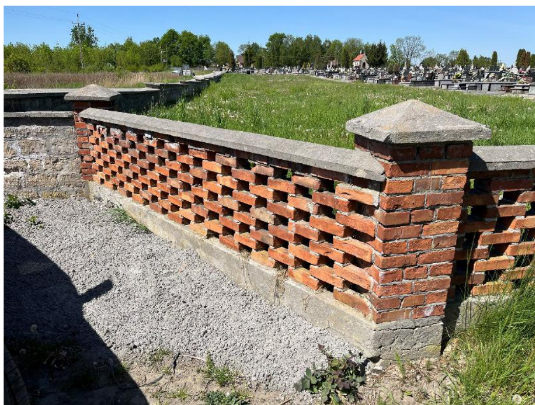
Fot. 35 – Zakres renowacji ogrodzenia cmentarza – daszki na słupku i nad przęsłem do wymiany na nowy element. Cegła w przęsłach ogrodzenia pomiędzy słupkami do wymiany na cegłę klinkierową. Źródło: własne
