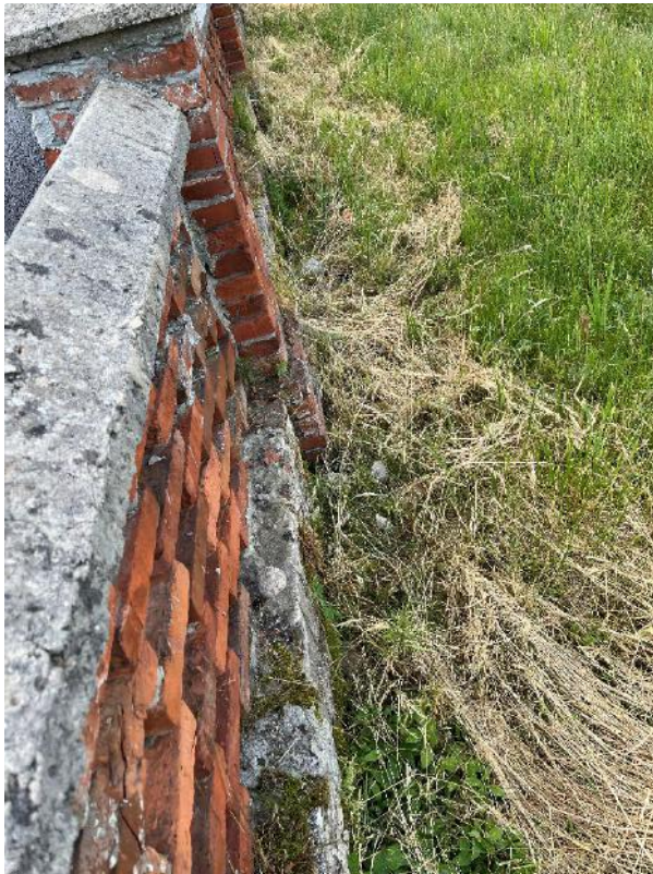
Fot. 37 – Zakres renowacji ogrodzenia cmentarza – fundament do naprawy. Źródło: własne
