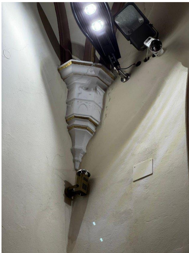
Fot. 32 – Pęknięcia ścian w kościele. Źródło: własne
