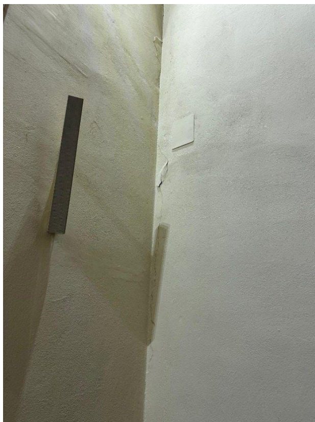
Fot. 31 – Pęknięcia ścian w kościele. Źródło: własne
