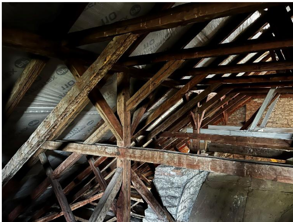
Fot. 40 – Stan więźby dachowej. Źródło: własne.
