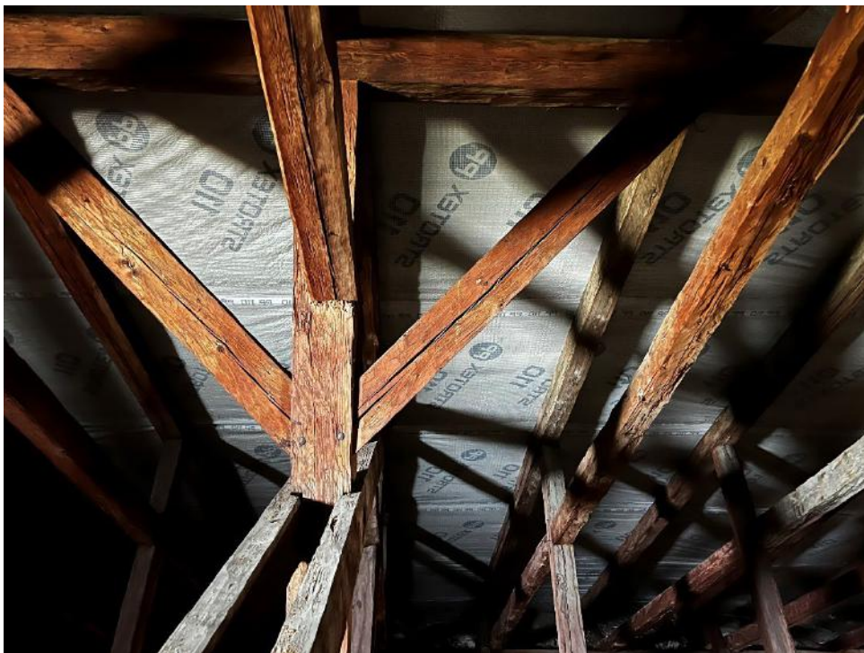
Fot. 43 – Stan więźby dachowej. Źródło: własne.
