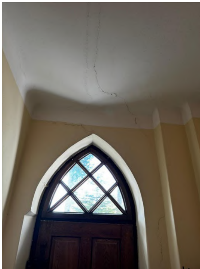
Fot. 29 – Pęknięcia ścian i sufitów w przedsionku. Źródło: własne
