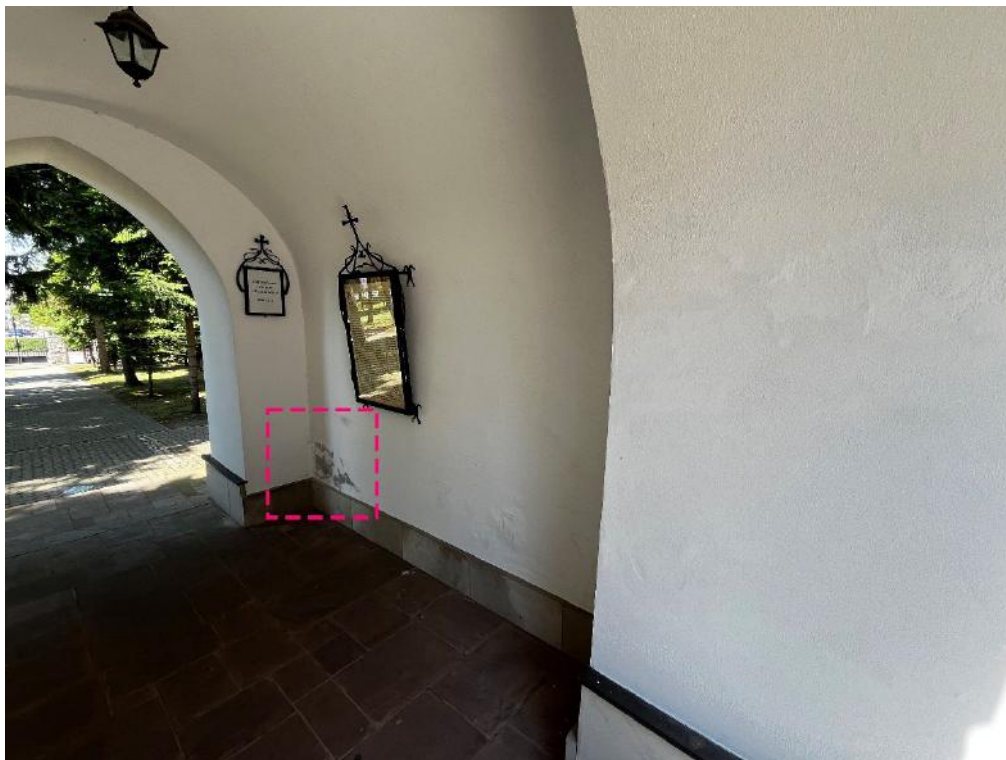
Fot. 23– Zniszczenia na ścianie przyziemi Źródło: własne
