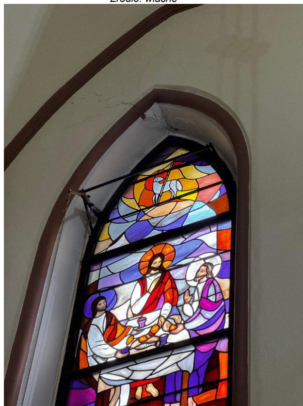
Fot. 33 – Pęknięcia ścian przy witrażach. Źródło: własne
