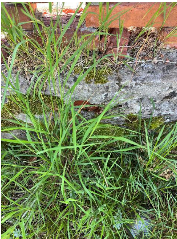
Fot. 36 – Zakres renowacji ogrodzenia cmentarza – fundament do naprawy. Źródło: własne
