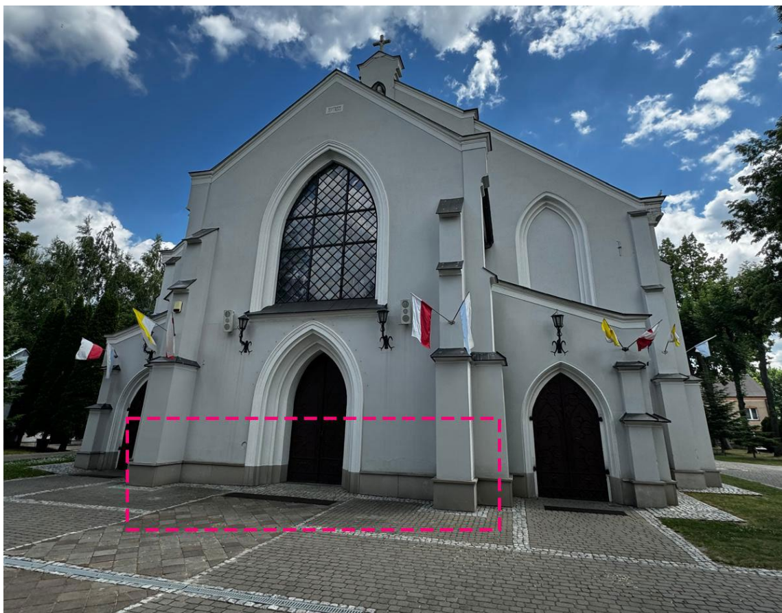
Fot. 15 – Zniszczenia na elewacji frontowej budynku kościoła (elewacja zachodnia). Źródło: własne
