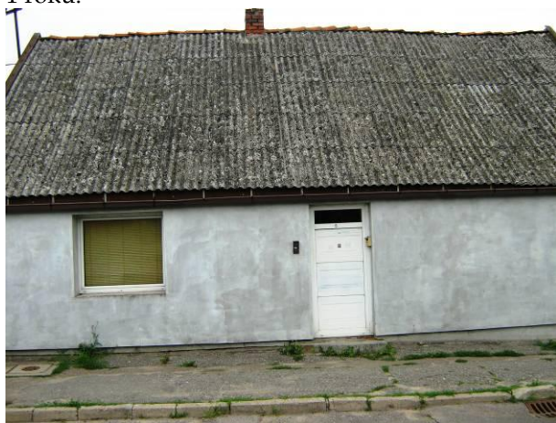
Rys. 7. Pokrycie dachowe ocenione w II stopniu pilności.
