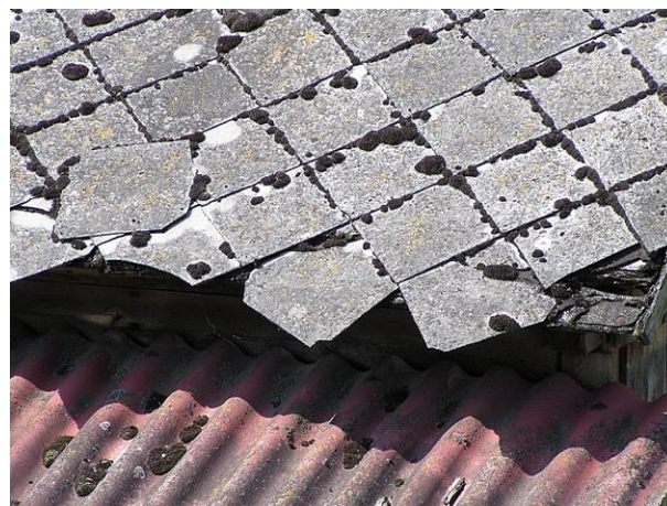
Rys. 8. Pokrycie dachowe ocenione w I stopniu pilności.
