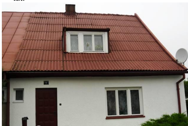
Rys. 6. Pokrycie dachowe ocenione w III stopniu pilności.
